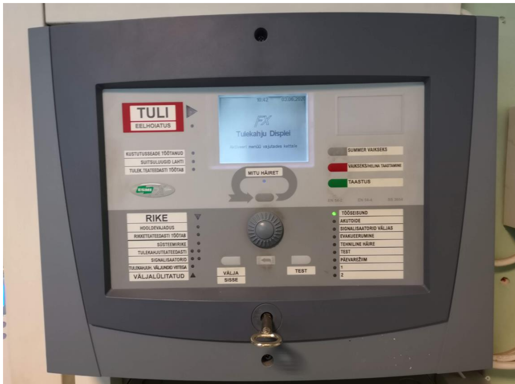
Foto. Hoone ATS keskseade.
