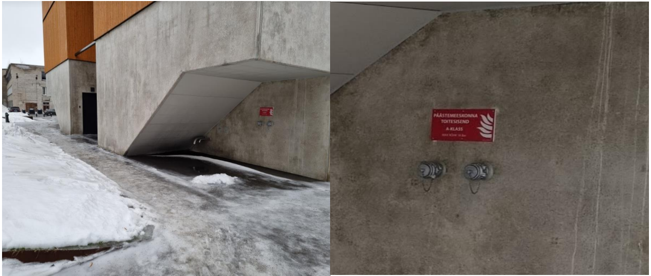
Pilt 9. Sprinklersüsteemiga ja märgtõusutoruga liitumise otsad.
