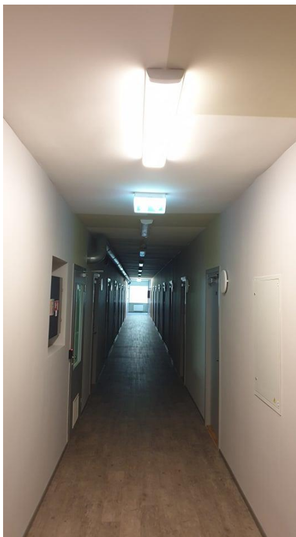
Pilt 10. Hoone evakuatsioonitee, kus põlevad evakuatsiooni- ja paanikavältimisvalgustid
