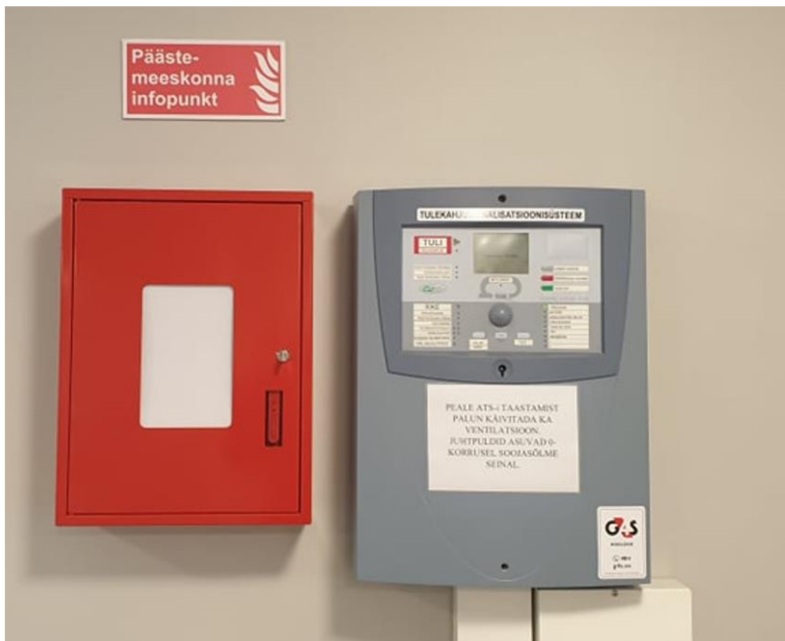
Pilt 2. Hoone Päästemeeskonna infopunkt (asub hoone fuajees peasissepääsu juures seinal), kus asub ATS keskseade (paremal), operatiivkaart ning päästetöö tegemiseks vajalikud skeemid.
