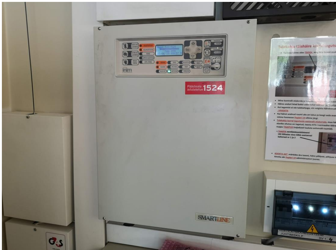
Foto. Hoone ATS keskseade.
