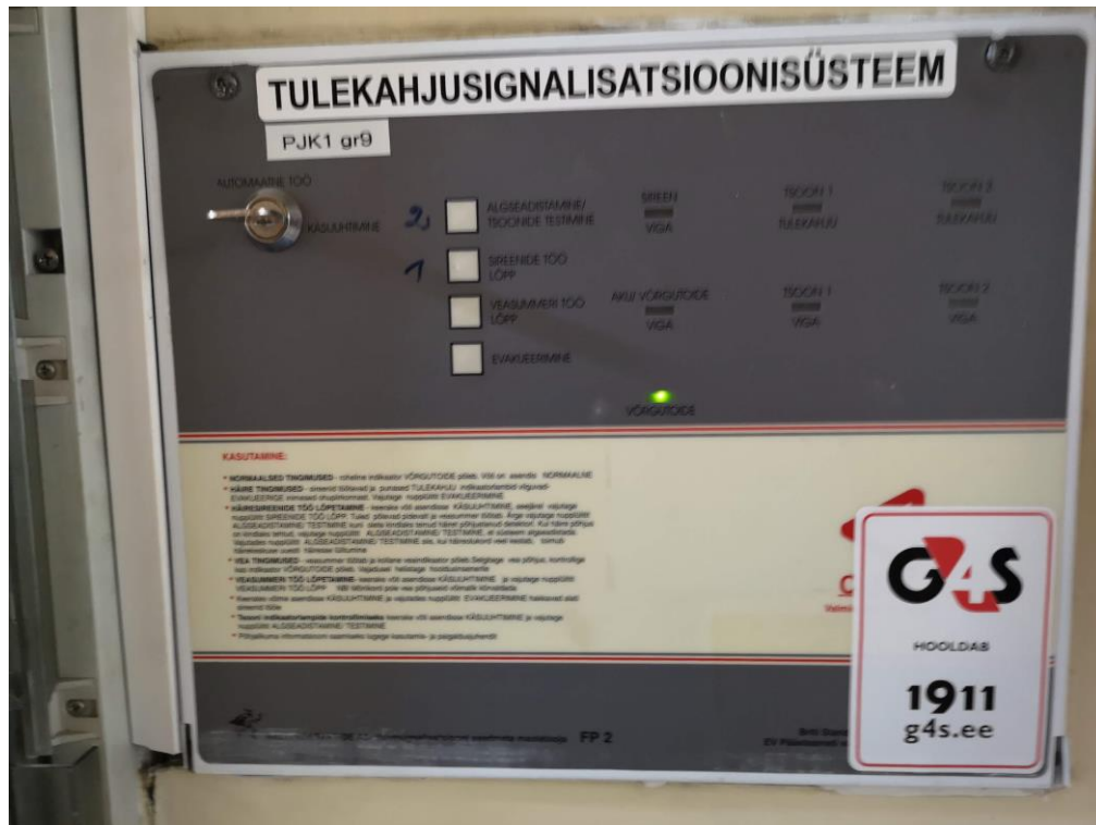
Foto. Hoone ATS keskseade.
