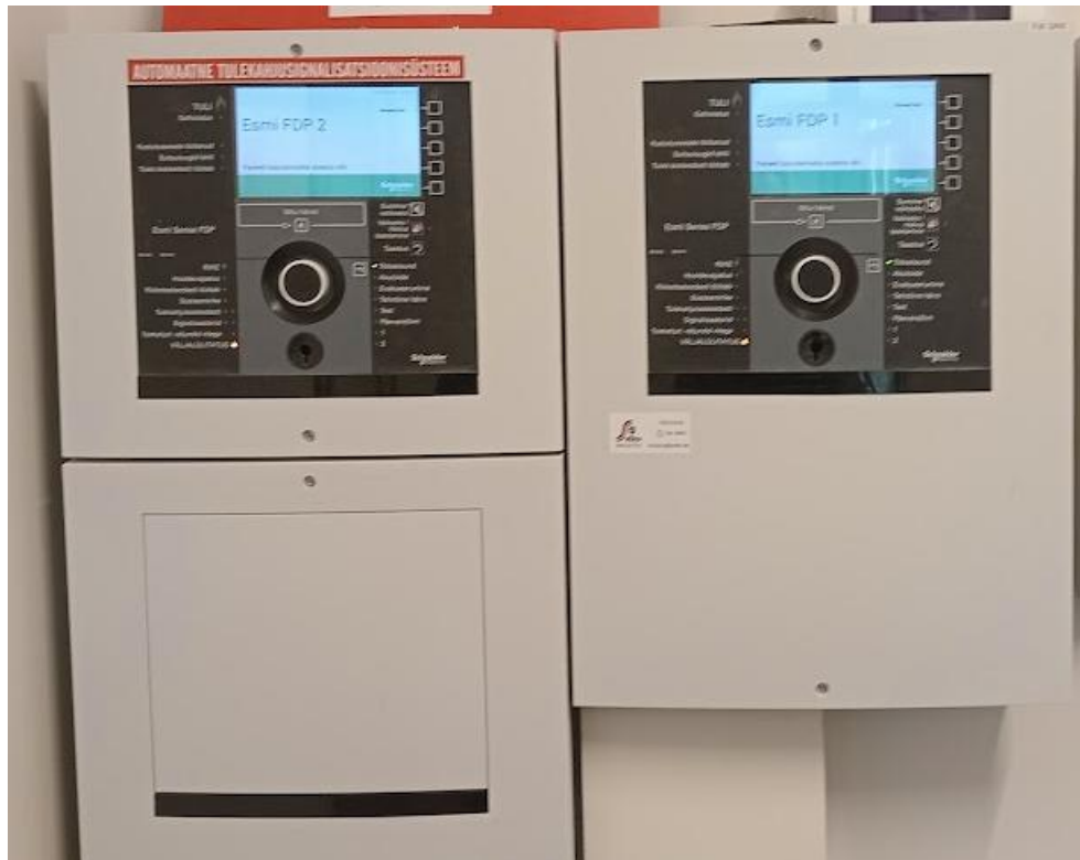
Foto. Hoone ATS keskseade.
